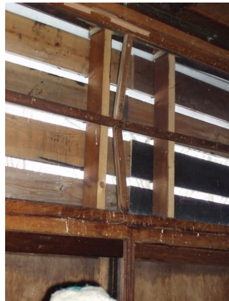
旧ベランダ上部の窓枠が変形 屋根からの圧雪と床から凍氷のせり上がり
