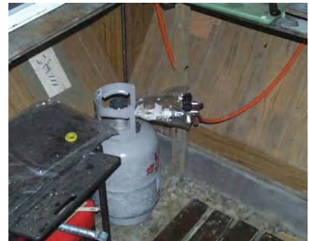
写真3 プロパン設置状況
