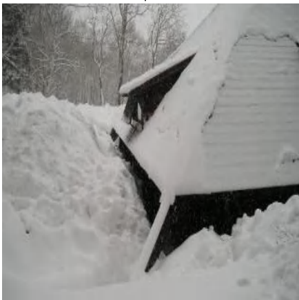
小屋雪下ろし後1
