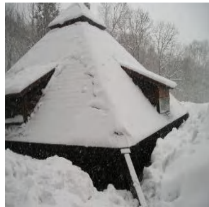
小屋雪下ろし後2
